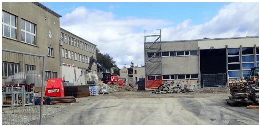
Rückbauarbeiten beim Schulareal Burghalde in Baden, welche durch die Monitron AG mittels 9 Messgeräten in Nachbarliegenschaften hinsichtlich auftretenden Erschütterungen überwacht wurden
