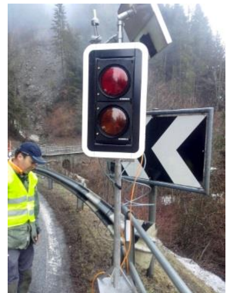
Ampelanlage für Verkehr und Fussgänger
